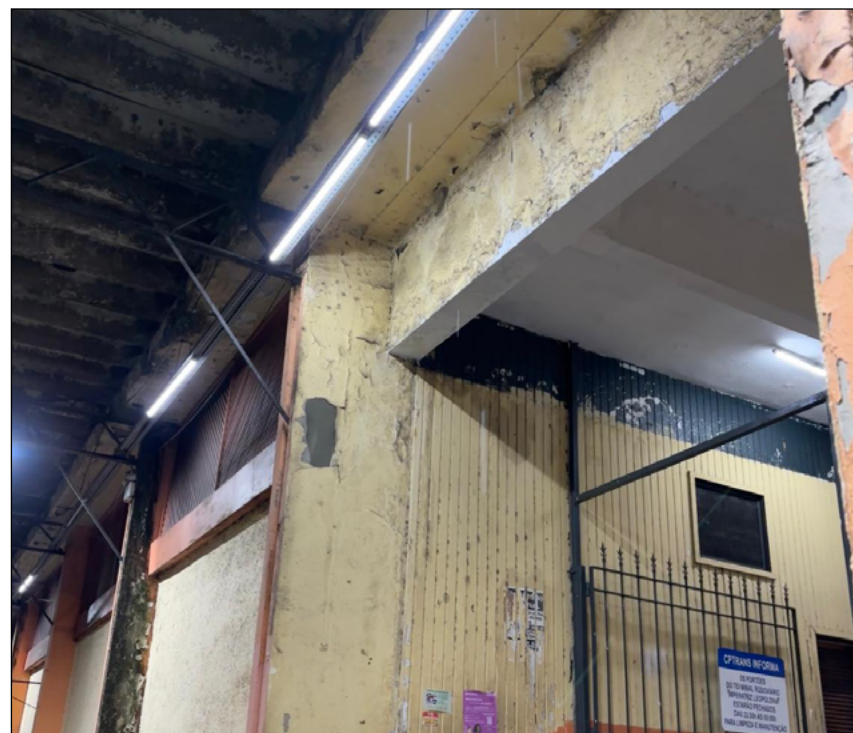
GOTEIRAS incomodam os passageiros que frequentam a rodoviária do Centro
