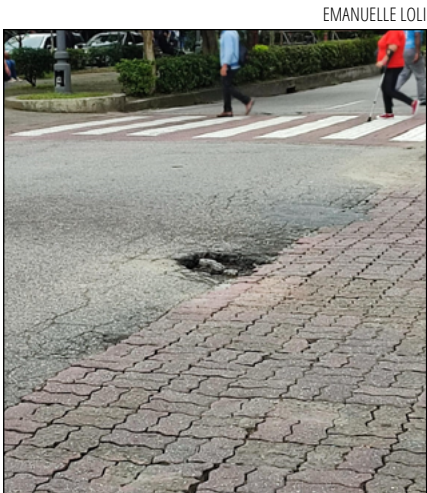
BURACO no meio da Rua do Imperador
