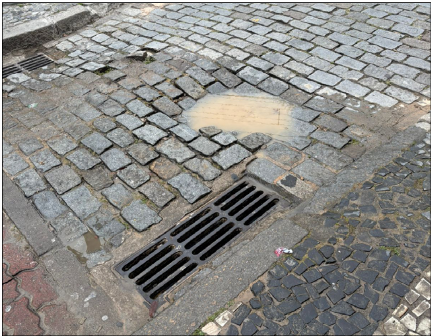
O VAZAMENTO de água formou um poça que molha os pedestres na calçada
