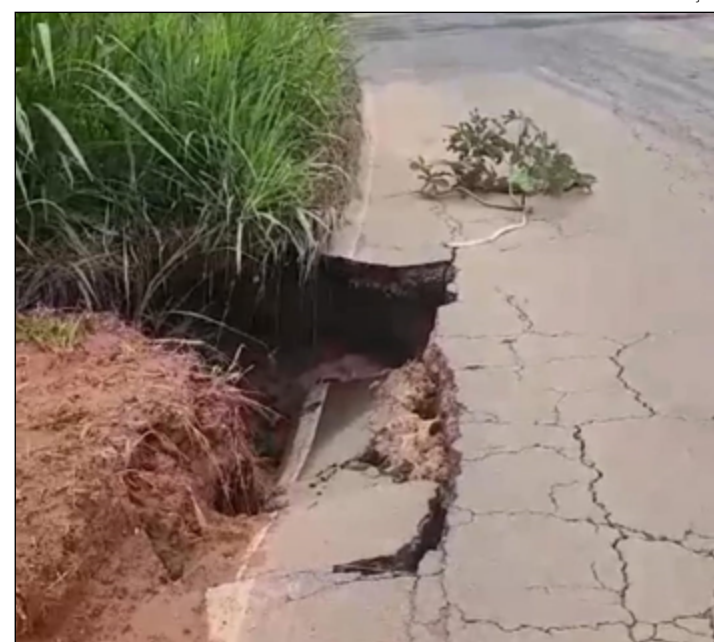
PARTE da pista cedeu e motoristas temem acidentes no local
