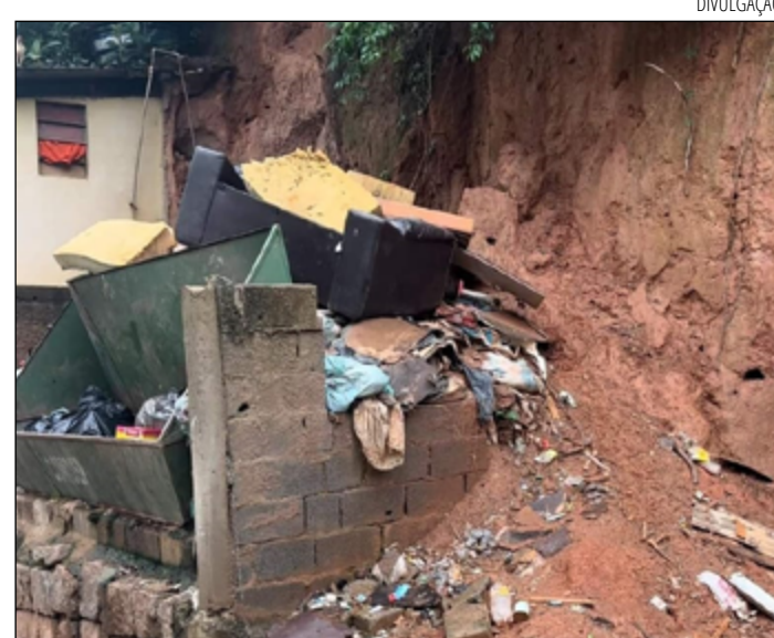
A LIXEIRA que atende a população do local está danificada
