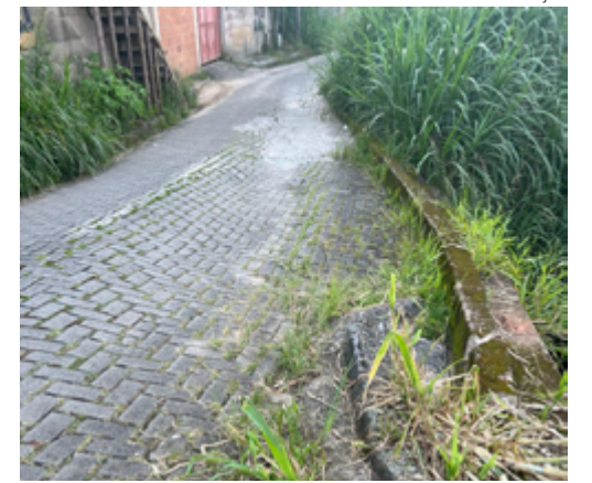
UM trecho da Rua Rio Grande do Sul cedeu
