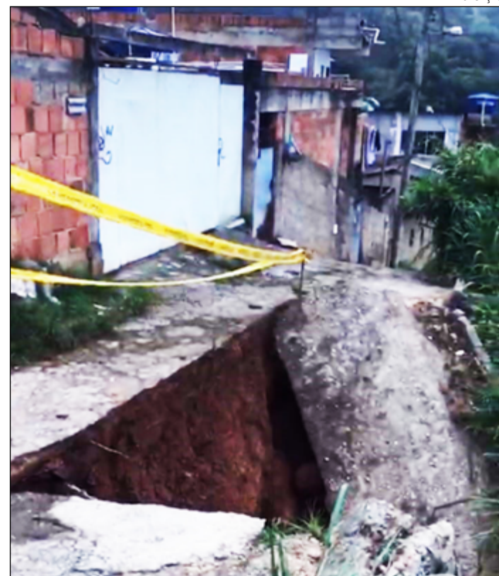
MORADORES ficaram sem água após o desabamento
