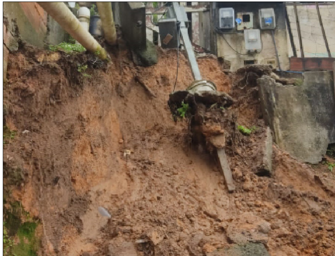
MORADORES temem novos desabamentos por conta das chuvas que vêm caindo na cidade
