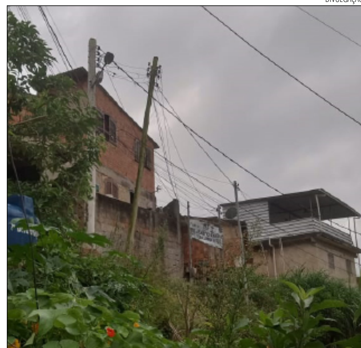
ENEL Distribuição Rio informou que vai avaliar a situação do poste
