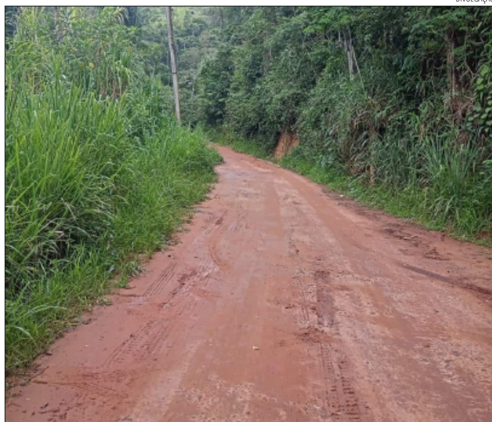
ESTRADA de terra vira pista de "rally" quando chove e prejudica o trânsito dos veículos
