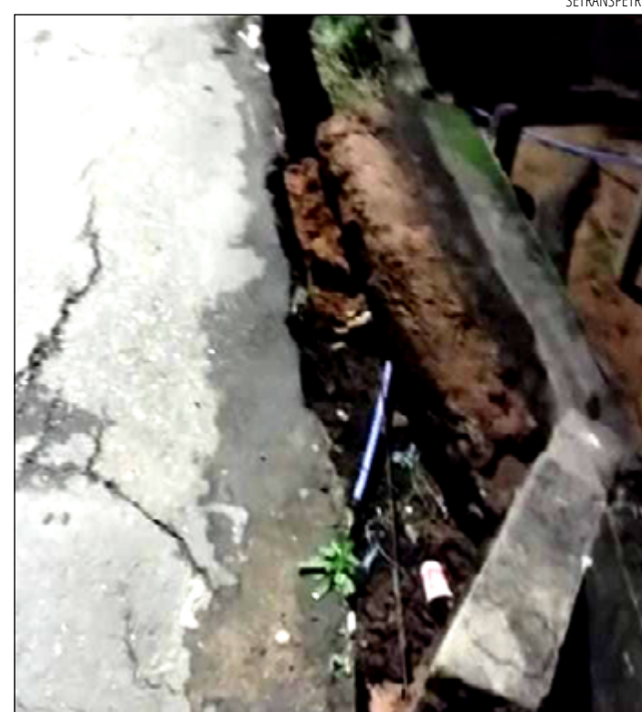
A PREOCUPAÇÃO é de que a rua ceda ainda mais com o tempo
