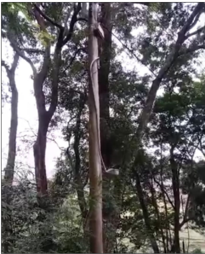
PROBLEMA em poste provoca queda no fornecimento de energia
