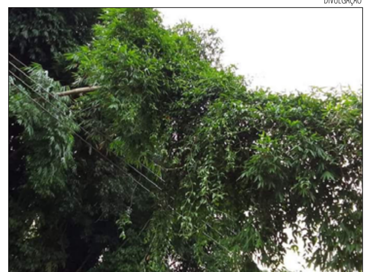
GALHOS sobre a fiação elétrica preocupam moradores do local
