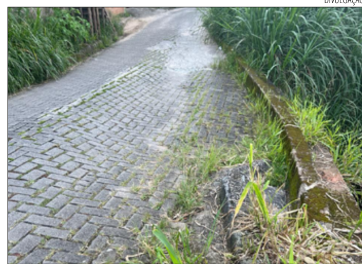
MOTORISTAS que trafegam no local temem que rua afunde mais
