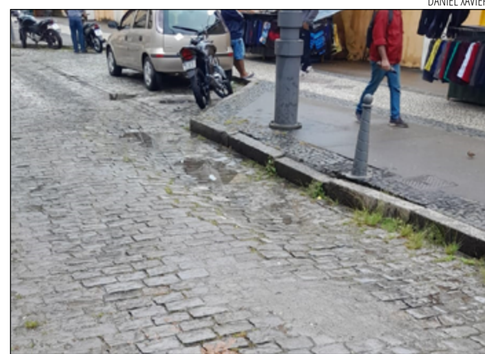
VAZAMENTO de esgoto e afundamento da rua preocupam
