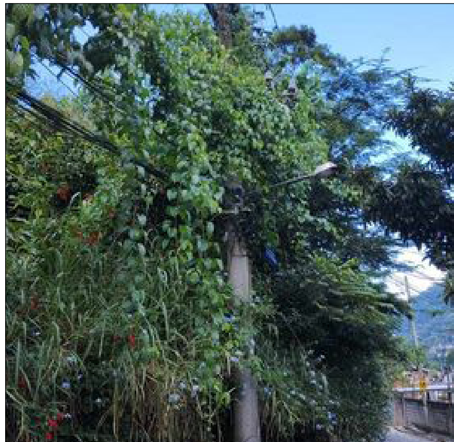
VEGETAÇÃO sobre os fios afeta o abastecimento de energia elétrica no local
