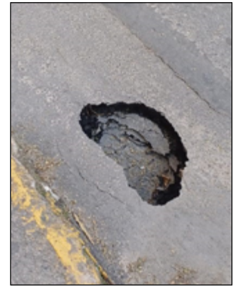
OUTRO buraco abriu na rua
