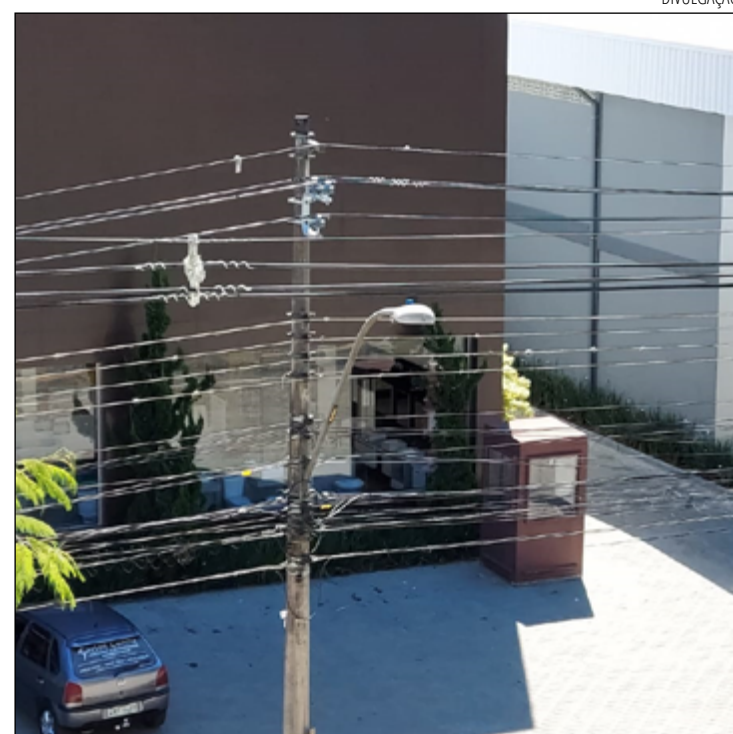
FALTA iluminação pública em grande parte da União e Indústria
