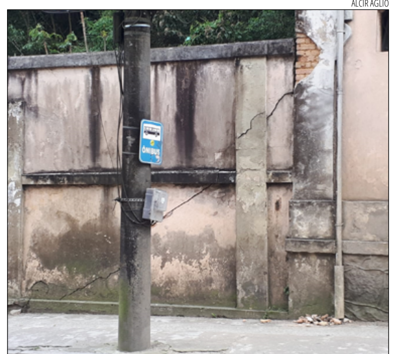
MURO com rachaduras em imóvel da Enel preocupa os pedestres
