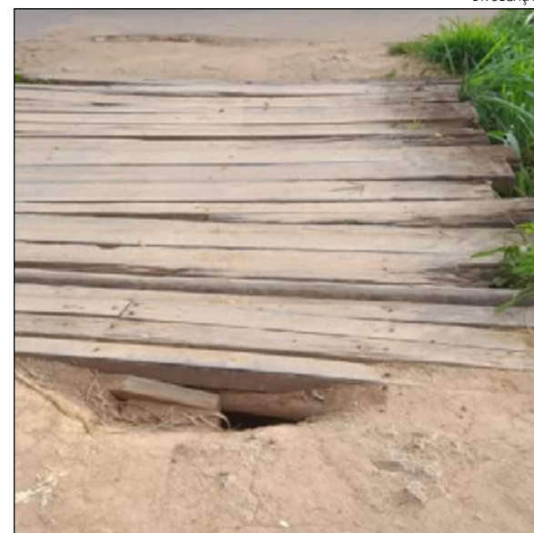
MOTORISTAS temem que a ponte de madeira desabe
