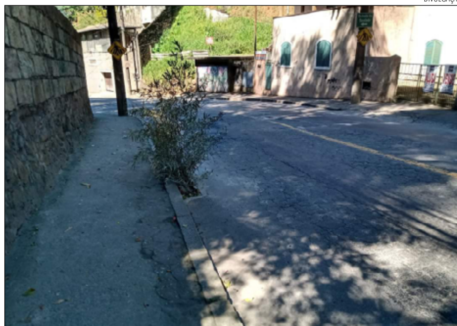
O BURACO bem próximo à calçada traz riscos para motoristas e também pedestres
