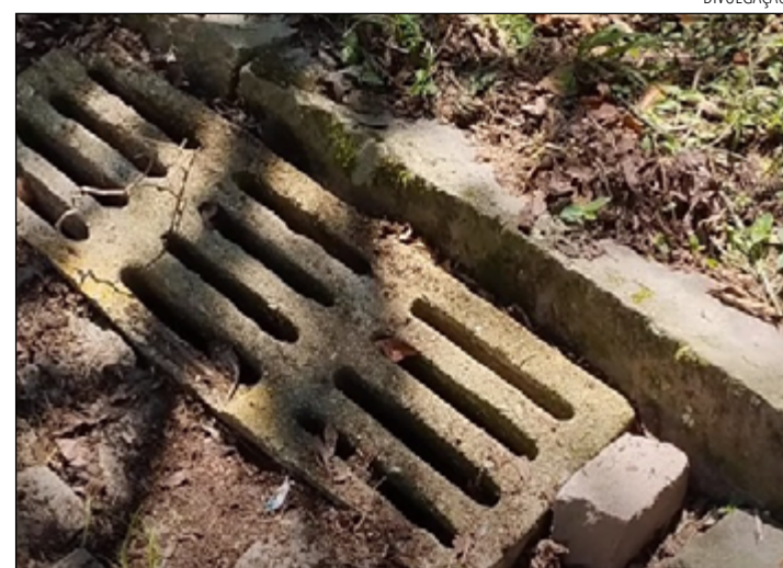
TAMPA do bueiro solta é um dos problemas reclamados
