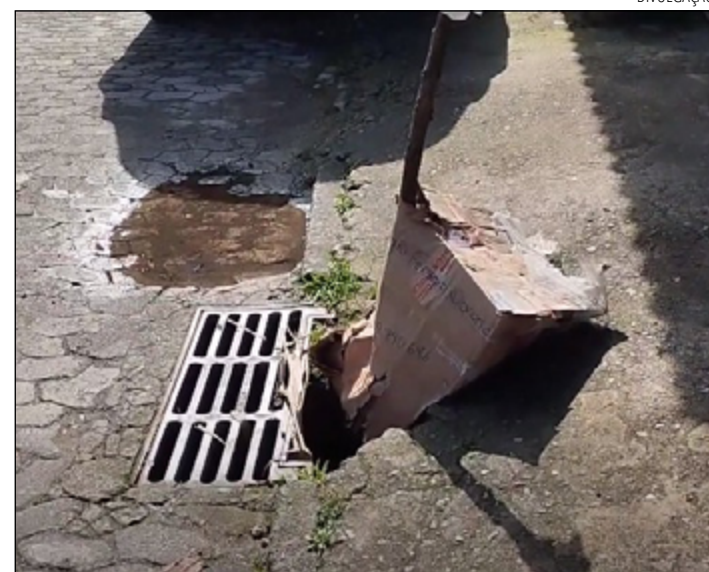
OS PRÓPRIOS moradores fizeram a sinalização do buraco
