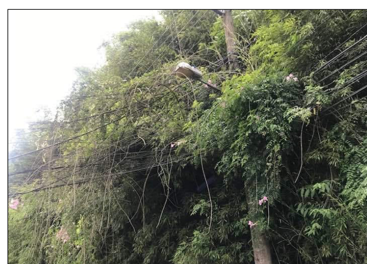
OS GALHOS sobre a fiação colocam em risco a rede de energia
