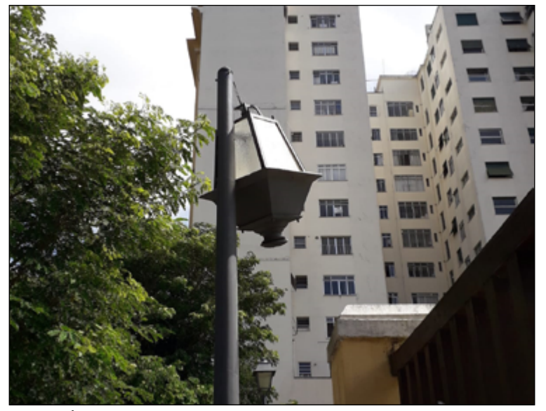
LUMINÁRIA está pendurada no topo do poste que fica no calçadão
