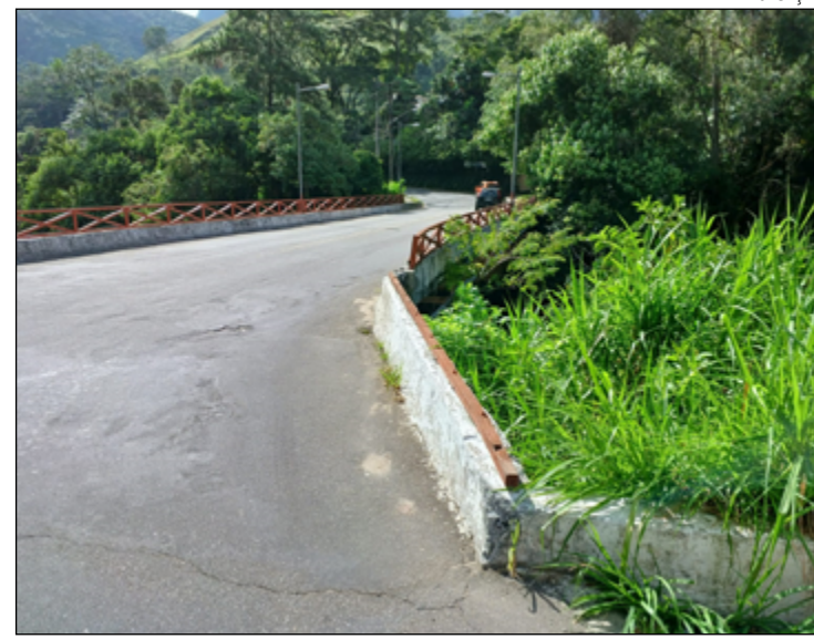
MATO alto e falta de guarda-corpo na ponte preocupam
