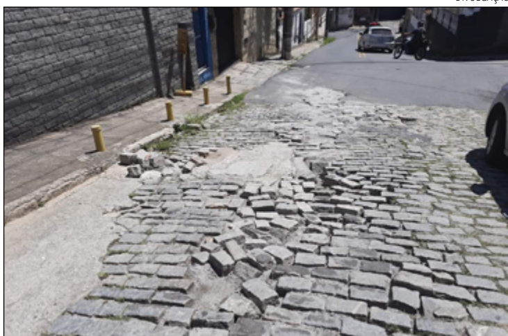
FALTA DE manutenção viária deixa rua desnivelada e com buracos
