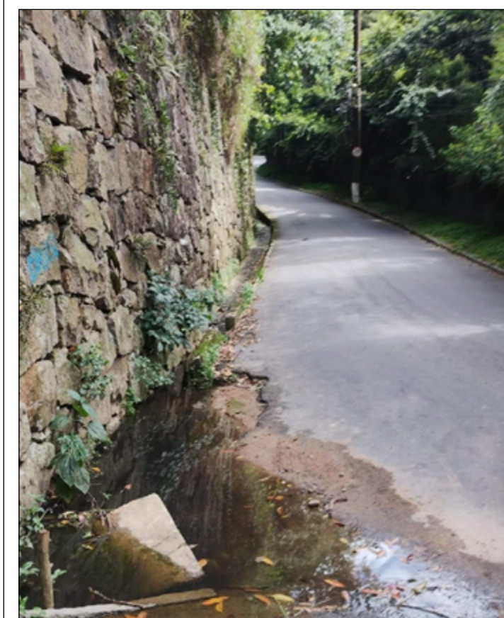
ÁGUA fica acumulada no bueiro e causa mau cheiro na rua
