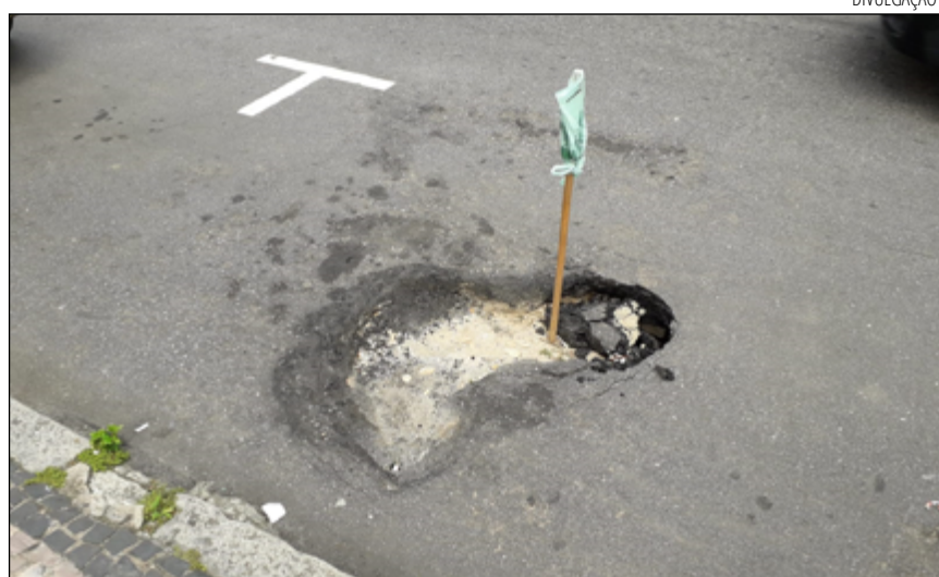
BURACO fica bem no meio de uma vaga de estacionamento rotativo da Rua
