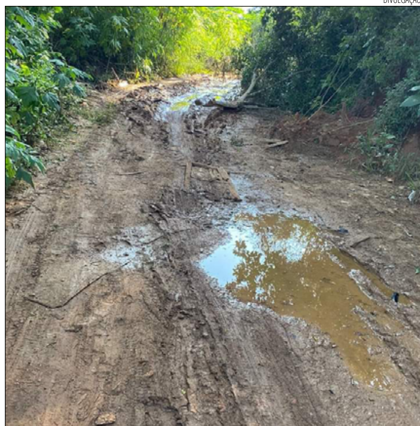
SEM asfaltamento, a estrada se torna um grande lamaçal em dias de chuva
