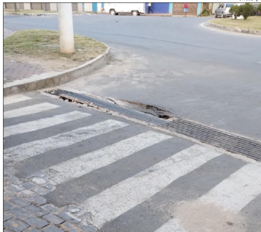
MOTORISTAS ficaram preocupados com a fenda que se abriu no asfalto
