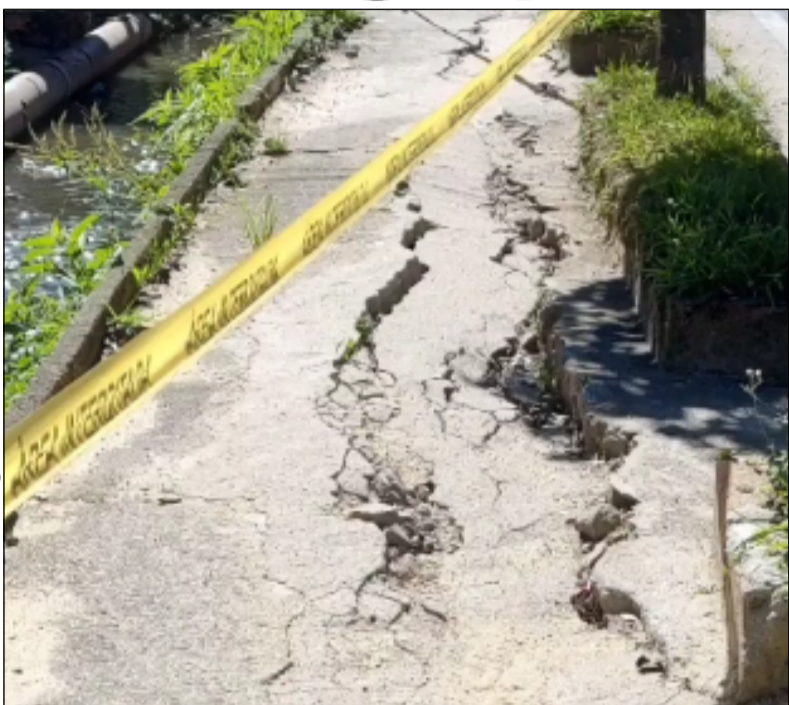
UM TRECHO da calçada precisou ser interditado por conta do problema
