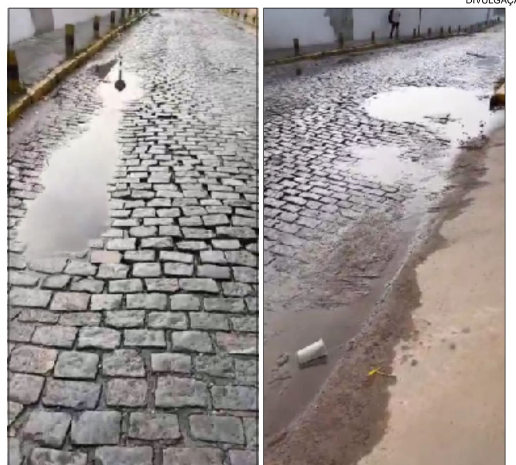
MORADORES motoristas reclamam do afundamento na rua que gera poças de água
