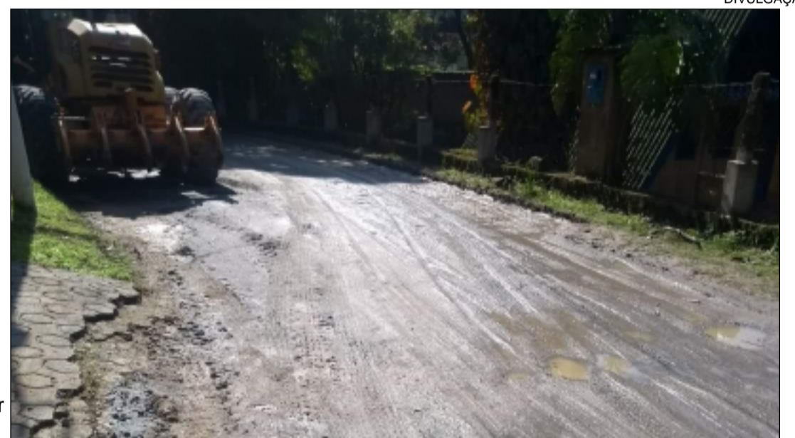
VAZAMENTO de água provoca lamaçal e interrompe as intervenções de asfaltamento da via
