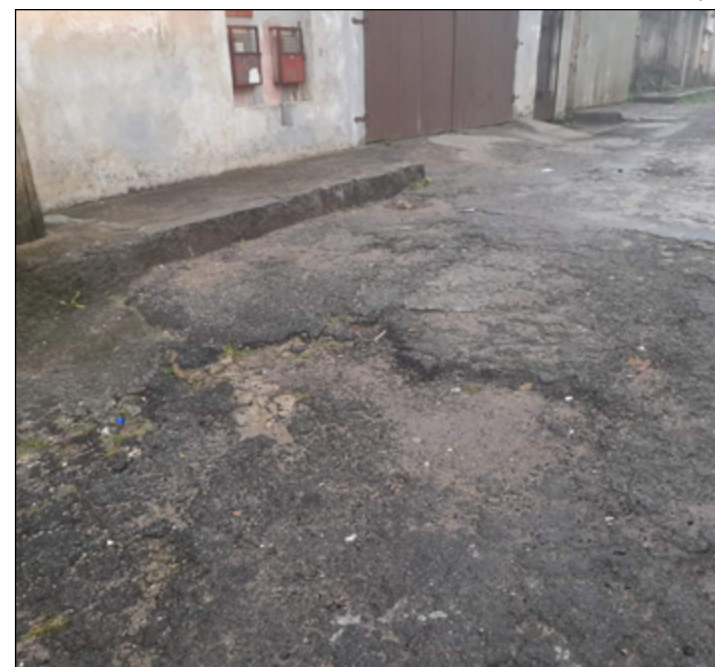
GRANDE quantidade de buracos prejudica o trânsito no local
