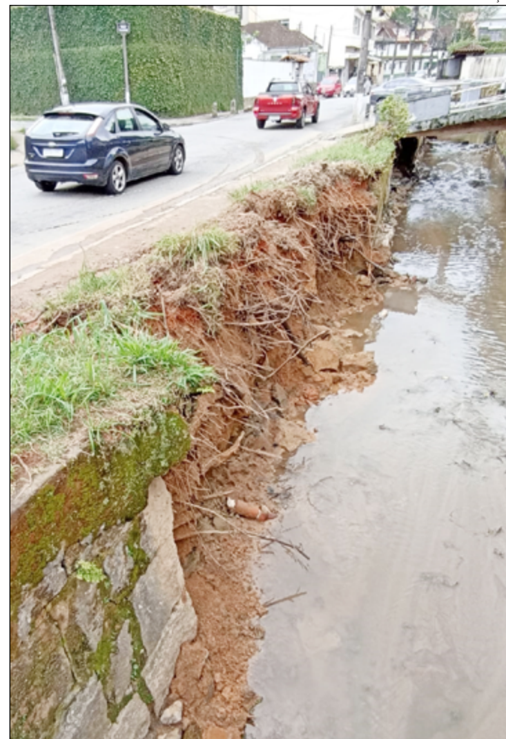
A MARGEM do rio desabou e a calçada precisou ser interdita
