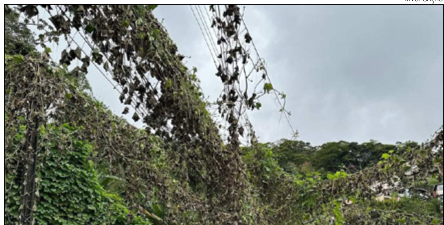
MORADORES temem interrupções dos serviços em função do mato na fiação
