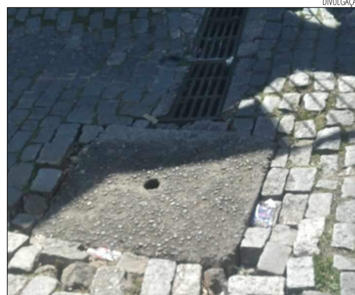
TAMPA ficou solta com o desalinhamento dos paralelepípedos
