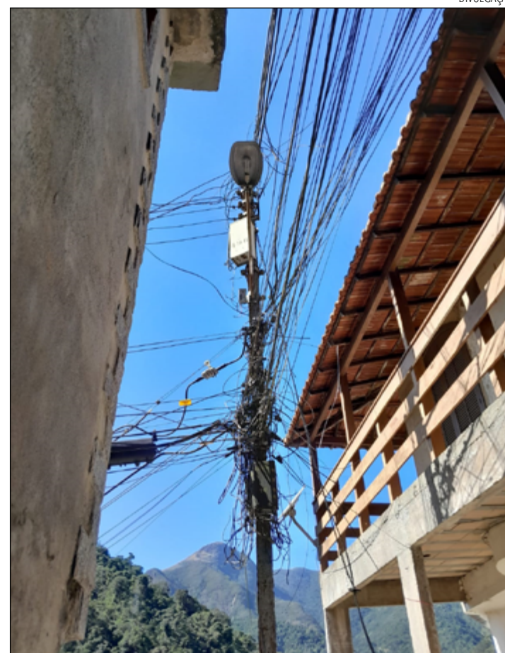
MAIS um poste com lâmpada queimada piora a situação na Vila
