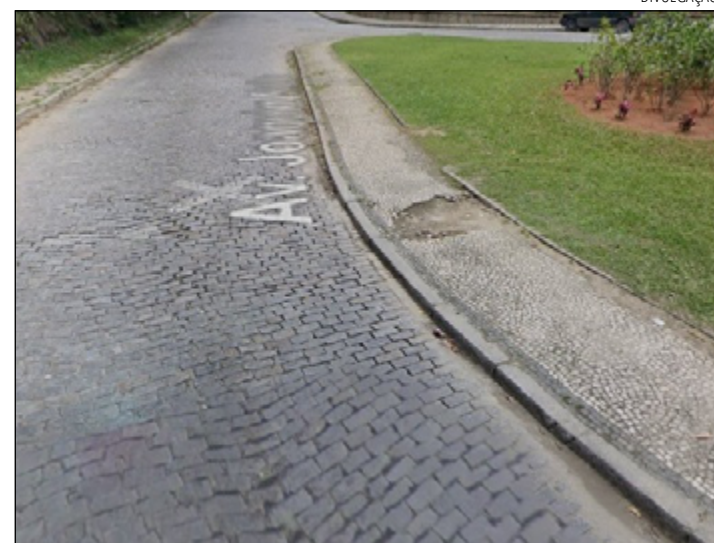
VÁRIAS partes da rua estão afundando com os paralelos soltos
