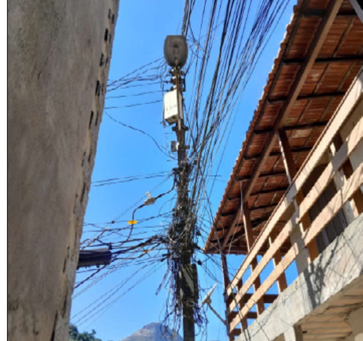
VILA DO Sossego está sem iluminação pública há dois meses
