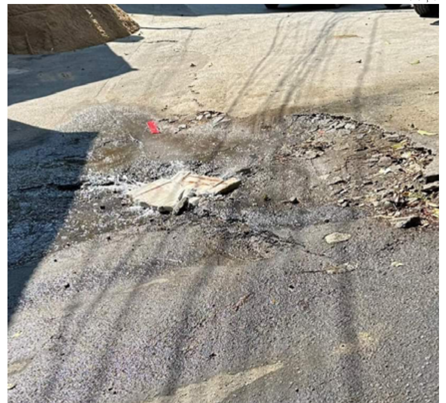
VAZAMENTO de água está abrindo um buraco na rua que tende a aumentar
