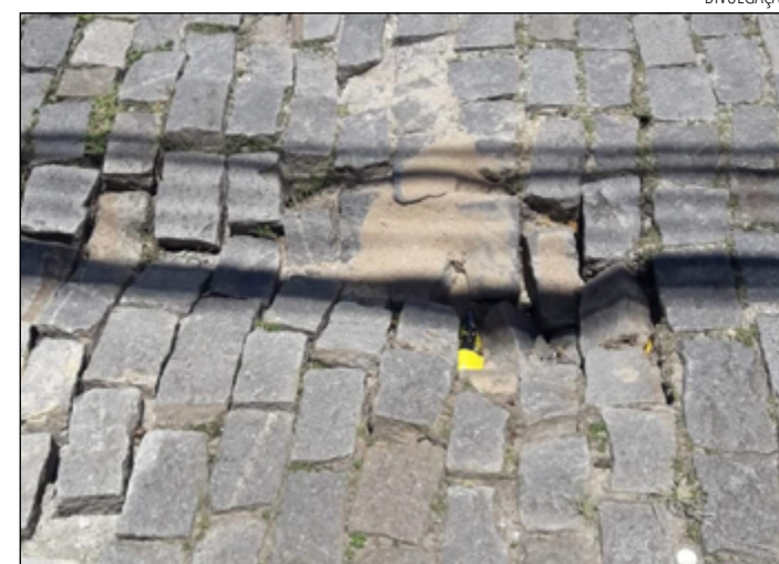
OS VÁRIOS desníveis na rua prejudicam o trânsito de veículos
