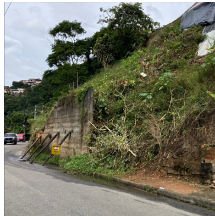
MORADORES estão preocupados com o risco de queda do muro
