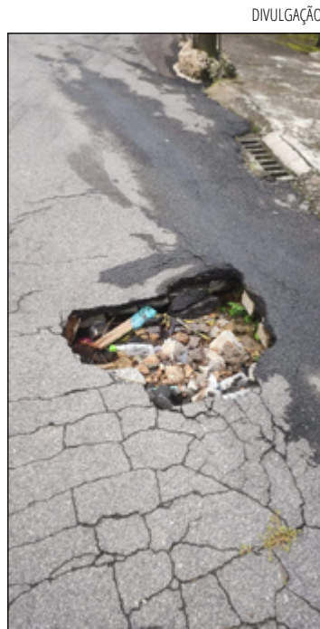
SÃO vários buracos na rua
