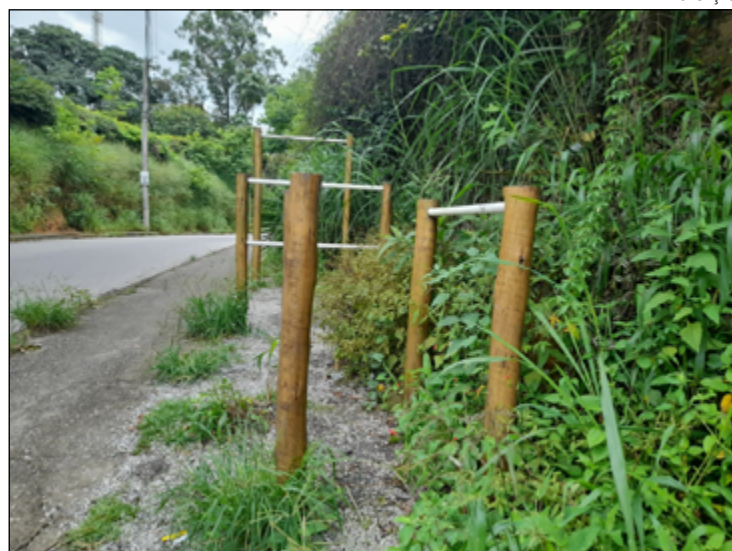
FALTA de capina e manutenção na calçada da José Carneiro Dias
