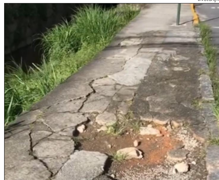
RACHADURAS e buracos podem causar acidentes aos pedestres
