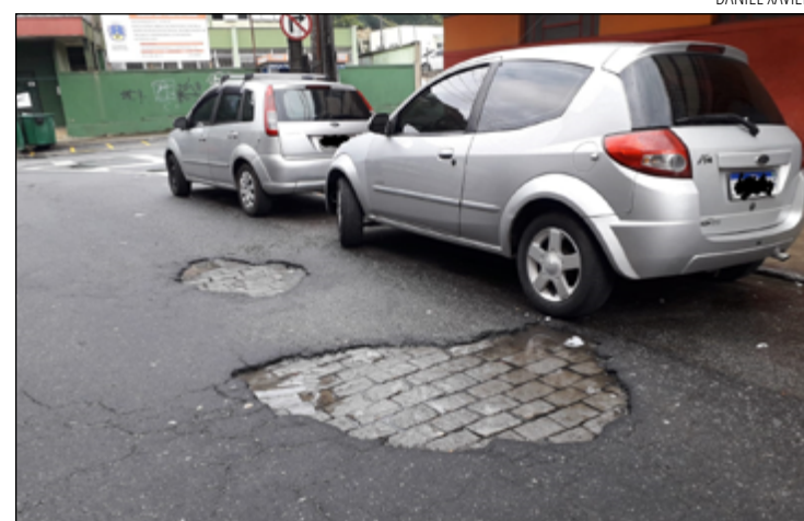
OS BURACOS estão entre as principais reclamações dos moradores
