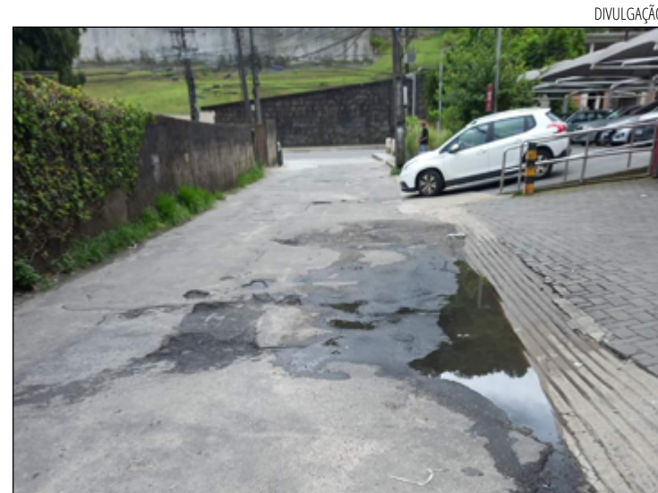
MOTORISTAS reclamam dos diversos buracos na Rua Jorge Justen
