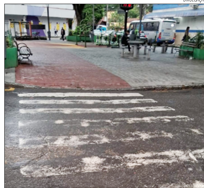
PEDESTRES estão inseguros com as faixas quase apagadas
