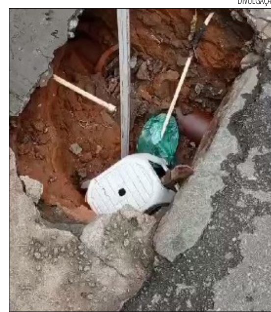
CRATERA na calçada afunda cada vez mais
