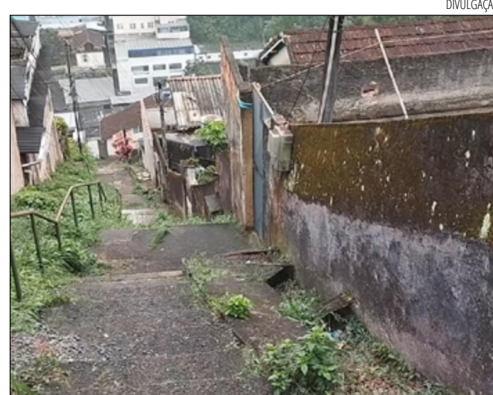
MORADORES relatam que diversas pessoas já caíram na escada
