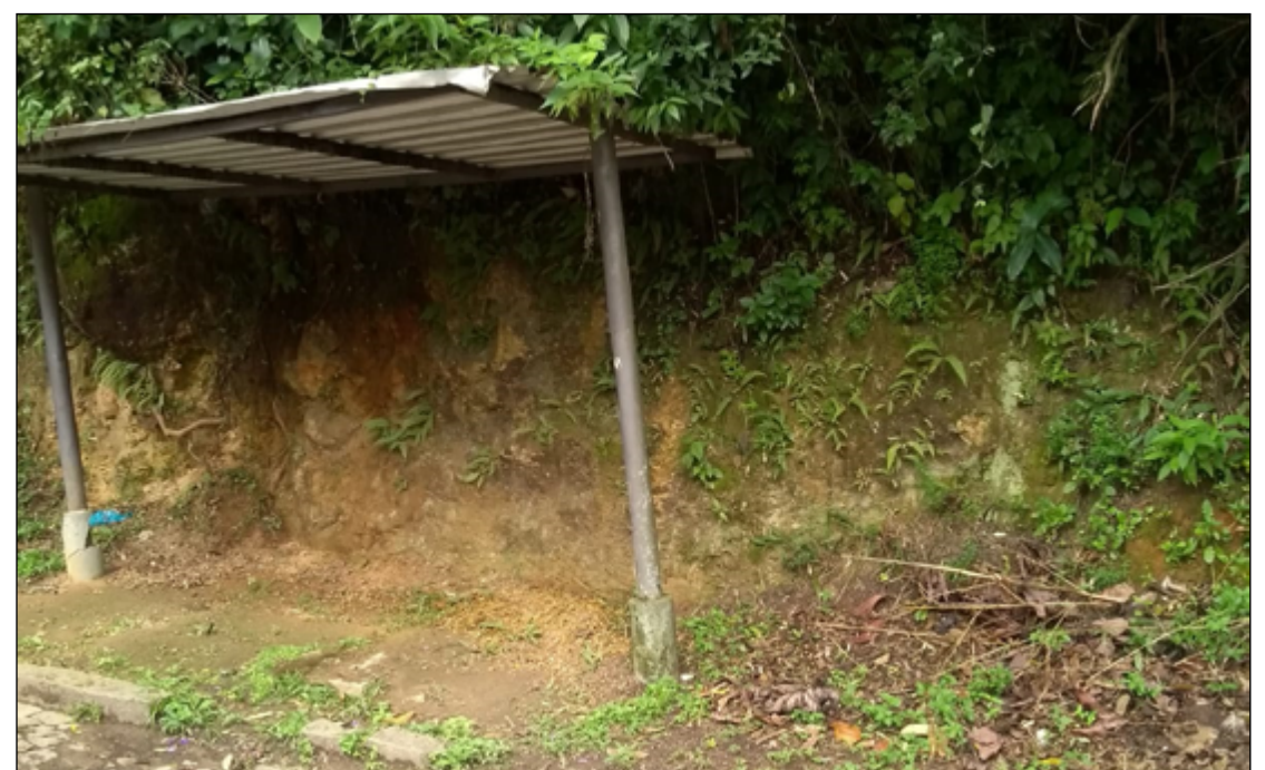
O ABRIGO de ônibus está bastante danificado e corre o risco de cair, gerando receio aos passageiros
