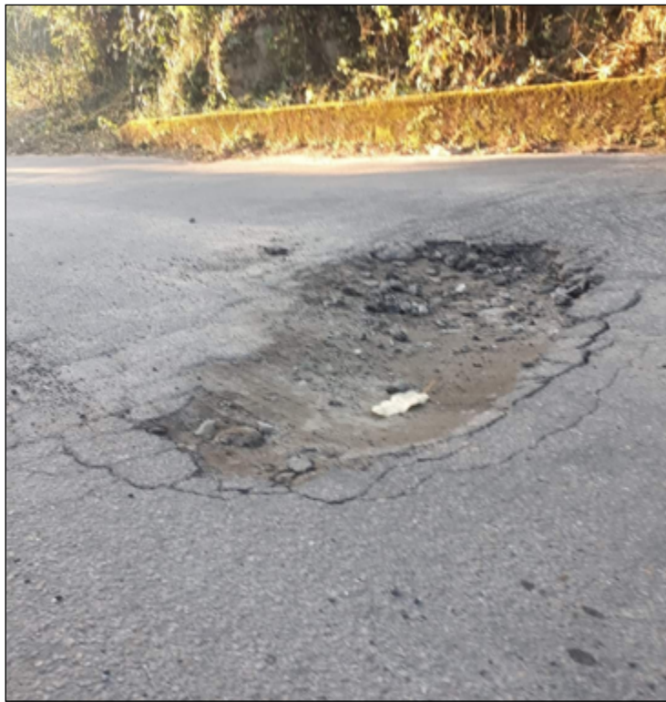
UM BURACO se abriu bem no meio da pista na Estrada do Brejal
