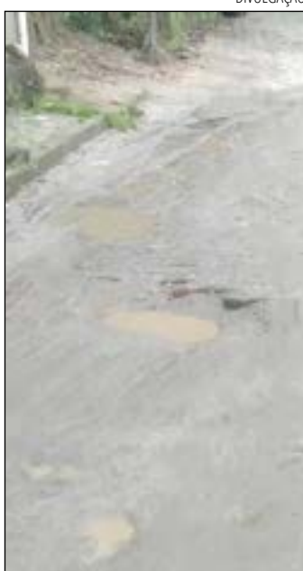
BURACOS sem sinalização
