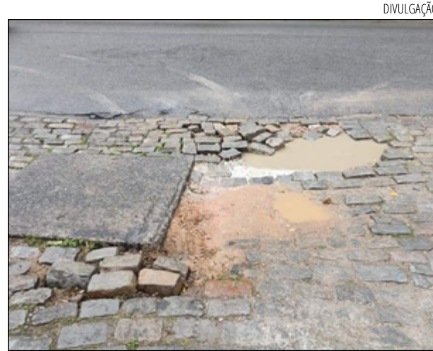
O BURACO fica na entrada da Vila e causa transtorno
