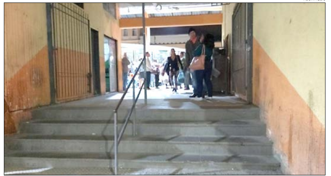
O TERMINAL também tem problemas com gesso caindo do teto sobre quem passa pelo local
