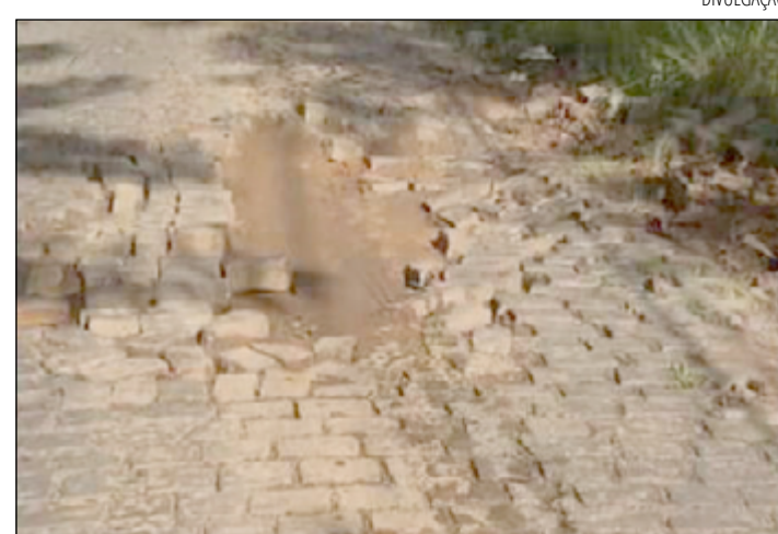
BURACOS estão aparecendo com a falta de paralelepípedos
