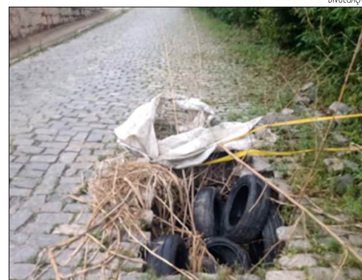
OS PRÓPRIOS moradores colocaram pneus e galhos no buraco
