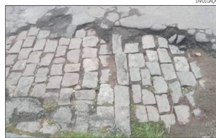
PERIGO para motoristas e pedestres em frente à quadra
