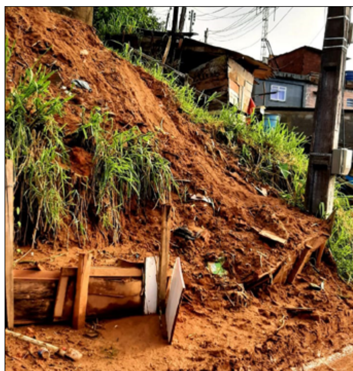
DESILZAMENTO de terra não foi retirado em rua do Valparaíso
