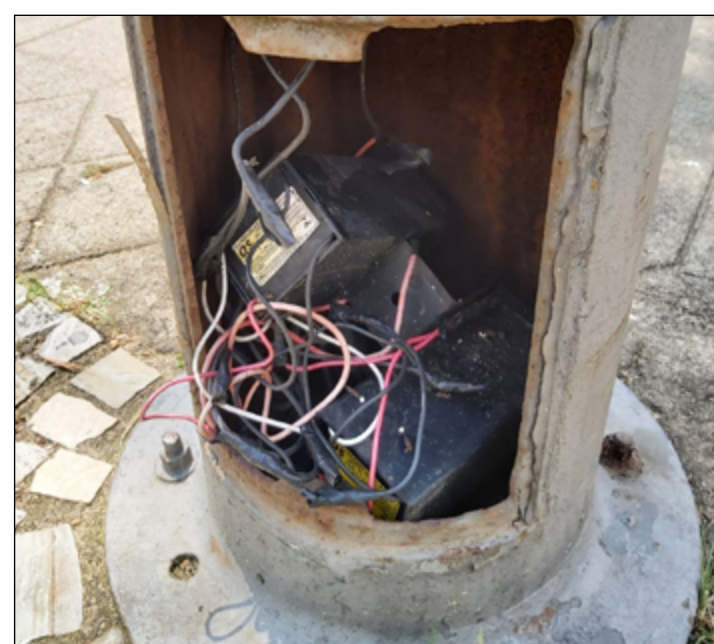
NA PRAÇA da Inconfidência fiação exposta e ferro soltos
