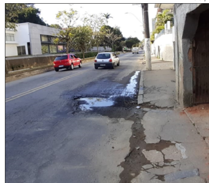
NA PISTA sentido Centro o buraco está aberto há dois meses
