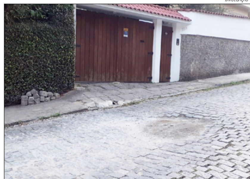
BURACO foi tapado com pó de pedra e paralelepípedos deixados na calçada
