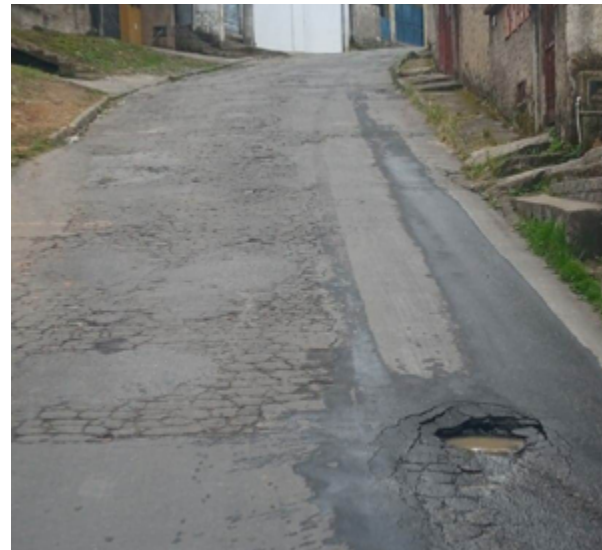
BURACO está aumentando de tamanho na Rua F
